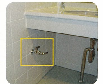
トイレの清掃用蛇口
